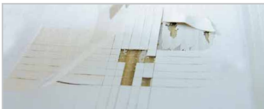
Powłoka, w której występują problemy z przyczepnością podkładu: w teście nacięcia kratowego powłoka oddziela się od drewna.
