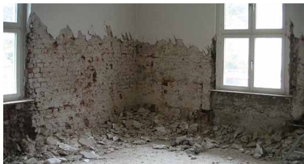
Przyciągający wilgoć stary tynk gipsowy na wewnętrznych stronach ścian zewnętrznych o grubości 30 do 100 mm trzeba było zastąpić tynkiem renowacyjnym lub cementowo-wapiennym.
