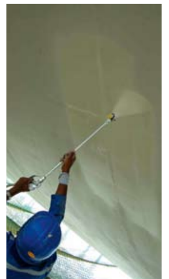
Trudna aplikacja na spodzie mostu
